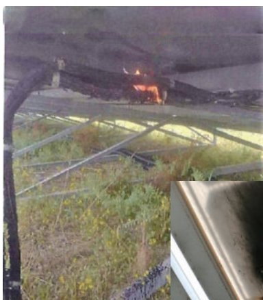
▲絶縁劣化によるケーブルからの出火
