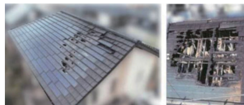
火災で燃えた太陽光パネル (引用：日経ビジネス 2019/2/4)
